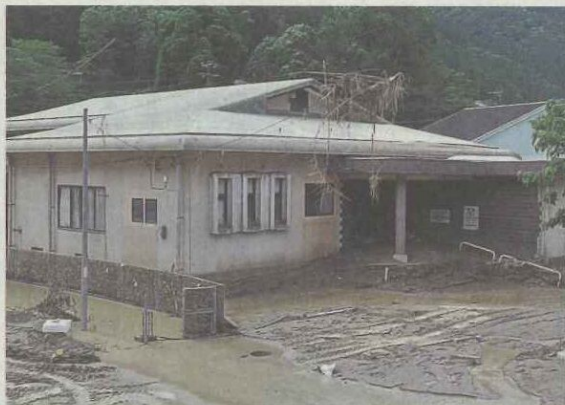
熊本県球磨村の神瀬多目的集会施設は指定緊急避難所だったが、昨年7月の豪雨で天井まで水没した =2020年7月23日
